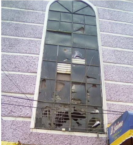
Ilustración 7 Daños por sismo
