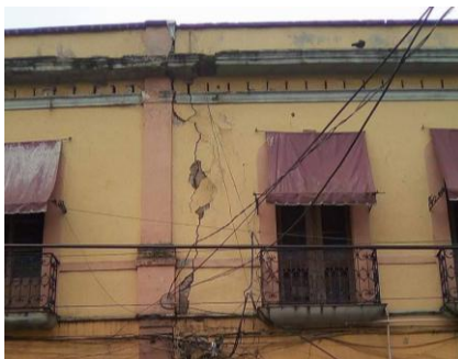
Ilustración 11 daño por sismo
