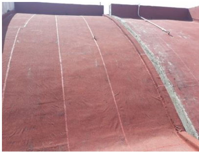
Foto22: Detalles por mala colocación de impermeabilizante
