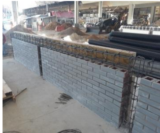
Foto4: Muro de 1 metro con tabique esmaltado
