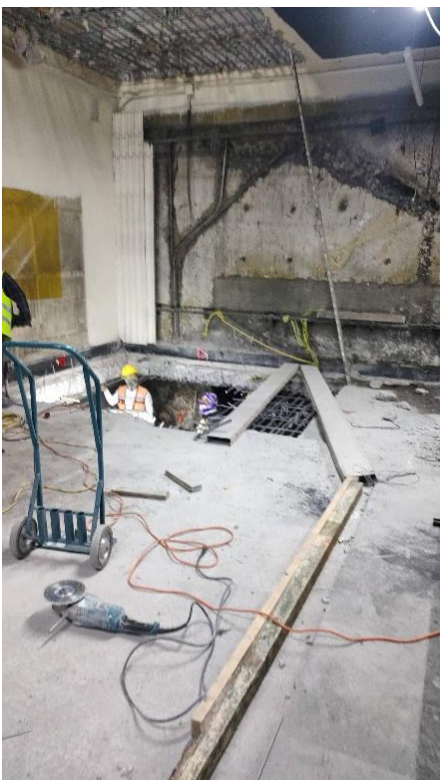
Ilustración 11. Huevo para Ducto de Elevador. Estación Cuauhtémoc
