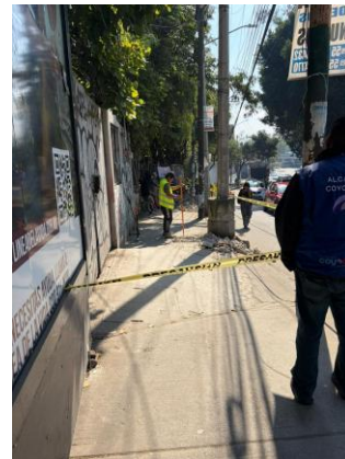
Foto 5.3 Vista general del frente de obra, supervisando el avance de los trabajos
