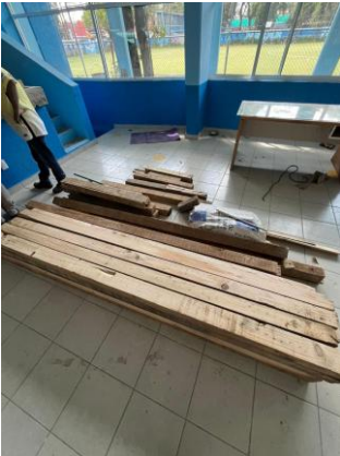
Foto 3.1 Vista interior del gimnasio durante el retiro del piso de madera existente
