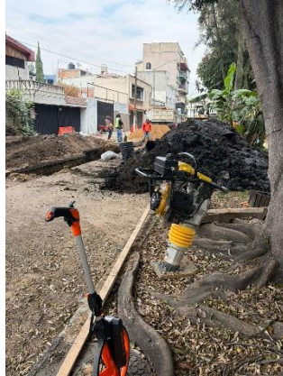
Foto 6.5 Detalle de tubería y equipo de trabajo durante el proceso de instalación
