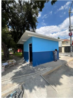
Foto 4.2 Vista exterior frontal de la caseta con los trabajos de terminación en proceso
