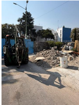
Foto 8.2 Vista general del sitio durante los trabajos de excavación y preparación del terreno
