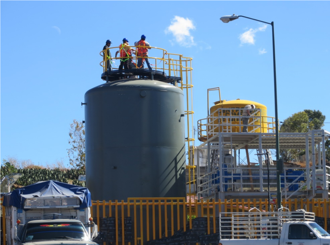
Imagen 6: Tanque de acero de carbono que mide ocho metros de alto por cuatro y medio de diámetro (biodigestor). Centro de acopio del nopal verdura Milpa Alta.
