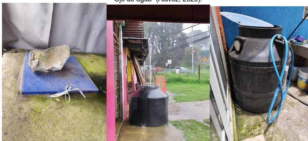
Almacenamiento en cisterna y captación de lluvia (Alavez, 2024).
