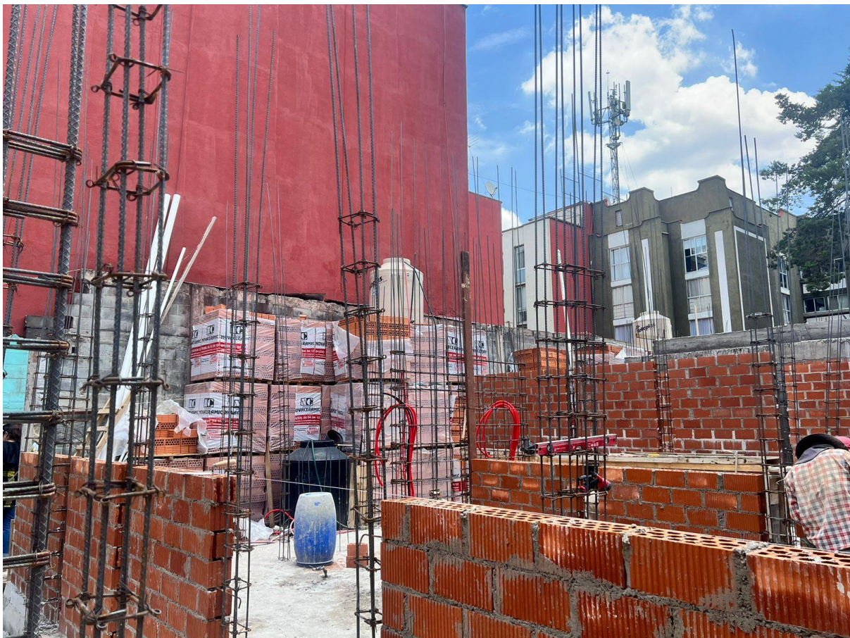
Imagen 19. Registro de visita: Se percibe el armado de los castillos para el primer nivel correspondiente al segundo núcleo de departamentos, así como el desplante de los muros.
