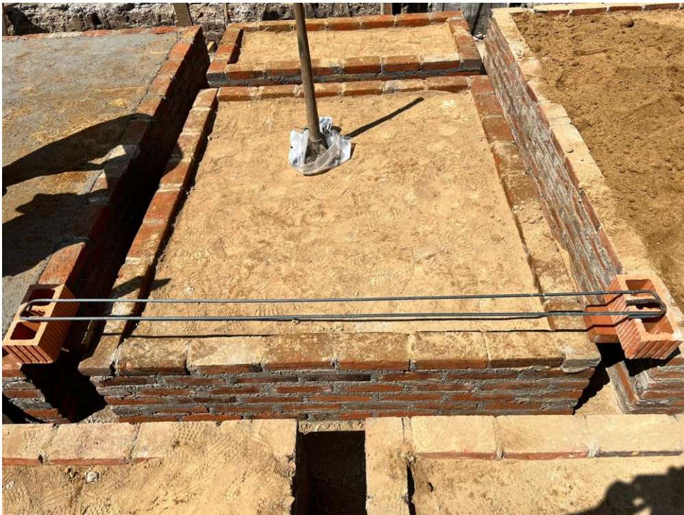
Imagen 6. Registro de visita: se realizó la compactación de tepetate en dos capas.
