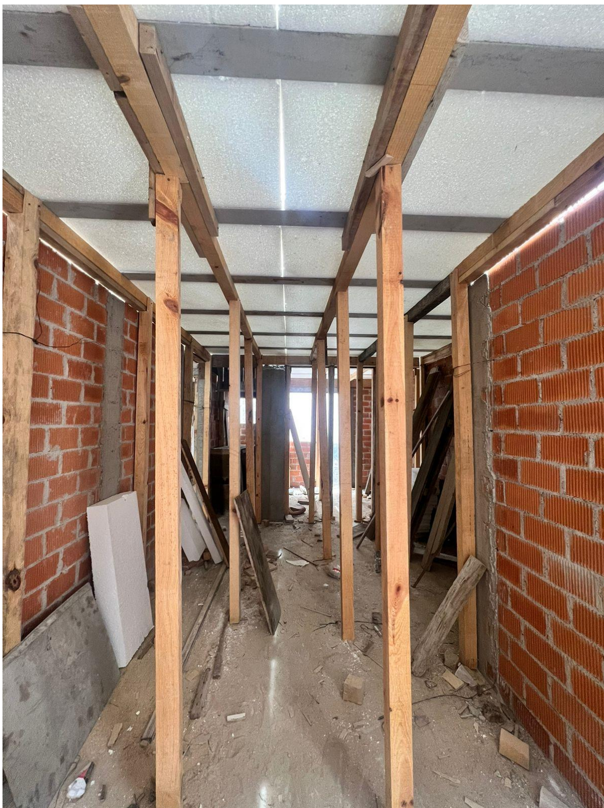
Imagen 13. Registro de visita: Se colocaron puntales días antes de colar la losa de entepiso.
