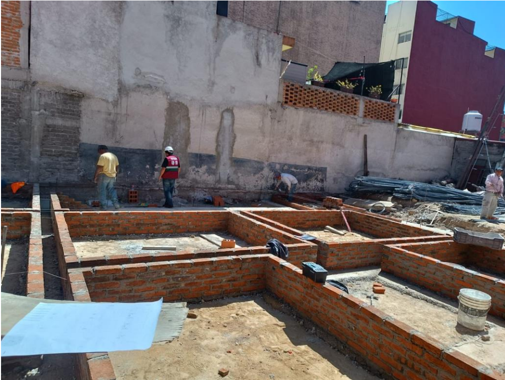
Imagen 5. Registro de visita: avance con el desplante de los cajones de cimentación.
