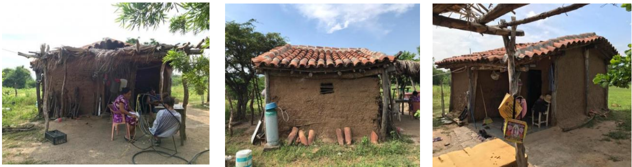
Figura 17. Fotografías tomadas sobre el avance constructivo de viviendas en Santo Domingo, Oaxaca, imágenes tomadas por : Zaldívar Lizet , 16/11/2022.
