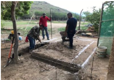
Figura 23. Fotografías tomadas de la cimentación de la galera viviendas en Santo Domingo, Oaxaca, imágenes tomadas por : Zaldívar Lizet , 16/11/2022.
