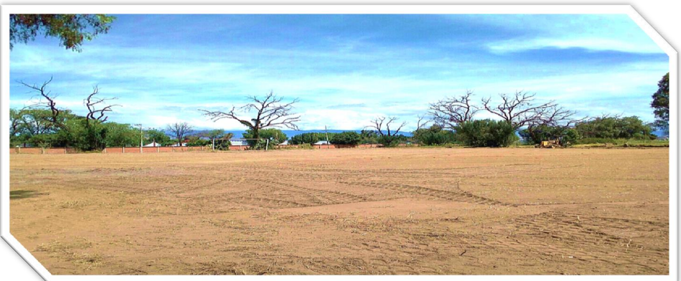
Fig. 5.3 Trabajos con maquinaria pesada como parte de la respuesta de autoridades universitarias
