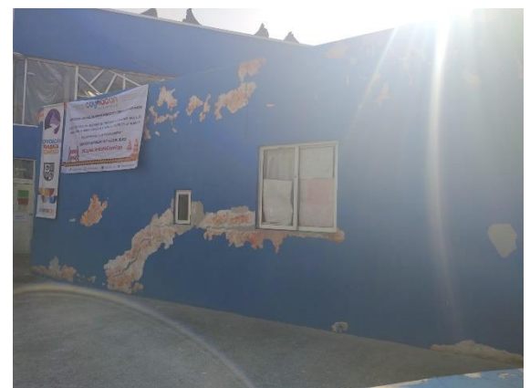
Figura 20. Fachada de la alberca Culhuacanes antes de la intervención. Fuente: Imagen propia.
