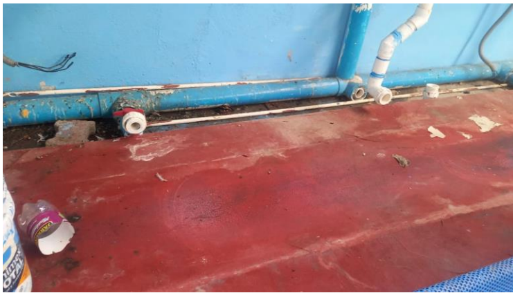
Figura 21. Impermeabilización en zona de bombas de la alberca Martí Haik. Fuente: Imagen propia.
