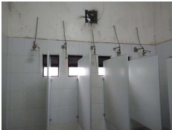
Figura 23. Sanitarios de la alberca Martí Haik antes de la intervención. Fuente: Imagen propia.
