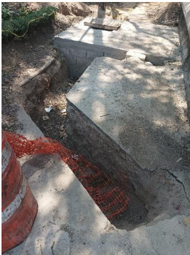
1. CISTERNA CREADA EN CIUDAD JARDÍN, PARA GUARDAR AGUA TRATADA QUE SERVIRÁ PARA RIEGO.
