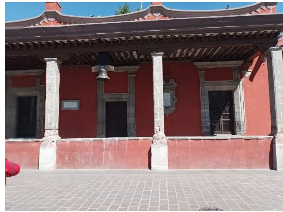
6. DAÑOS EN LA FACHADA PRINCIPAL, OCASIONADOS POR LA PRESENCIA DE LAS PALOMAS
