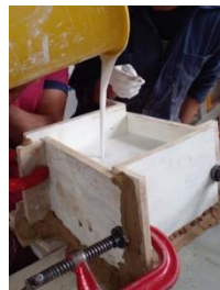
Fotografía 11. Yeso vertido en el límite del encofrado.
