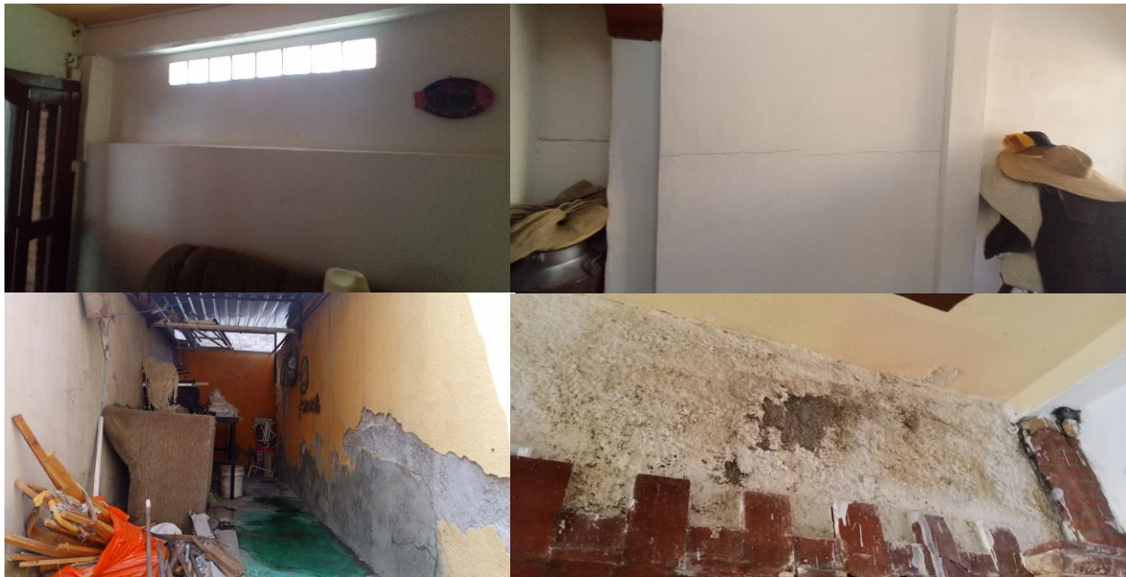
Figura 3.23 Reporte fotográfico al interior de la vivienda para el registro de daños.
