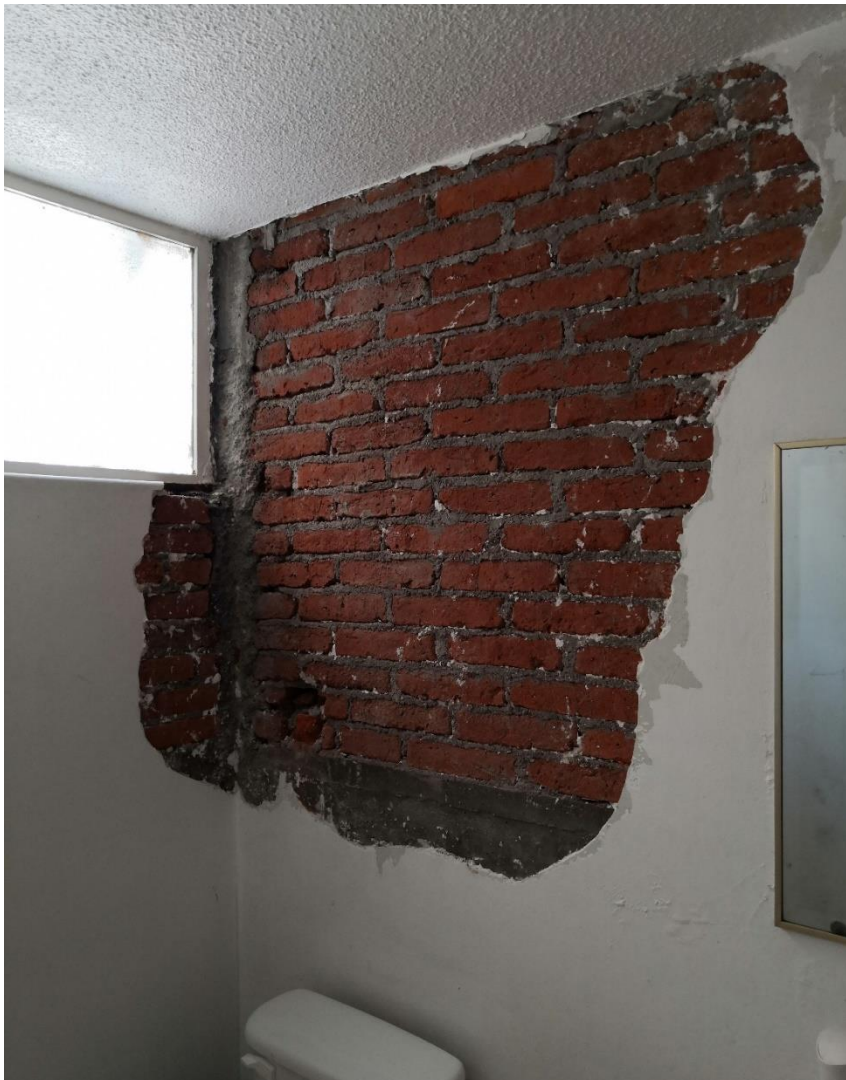
Ejemplo de estado de deterioro.
