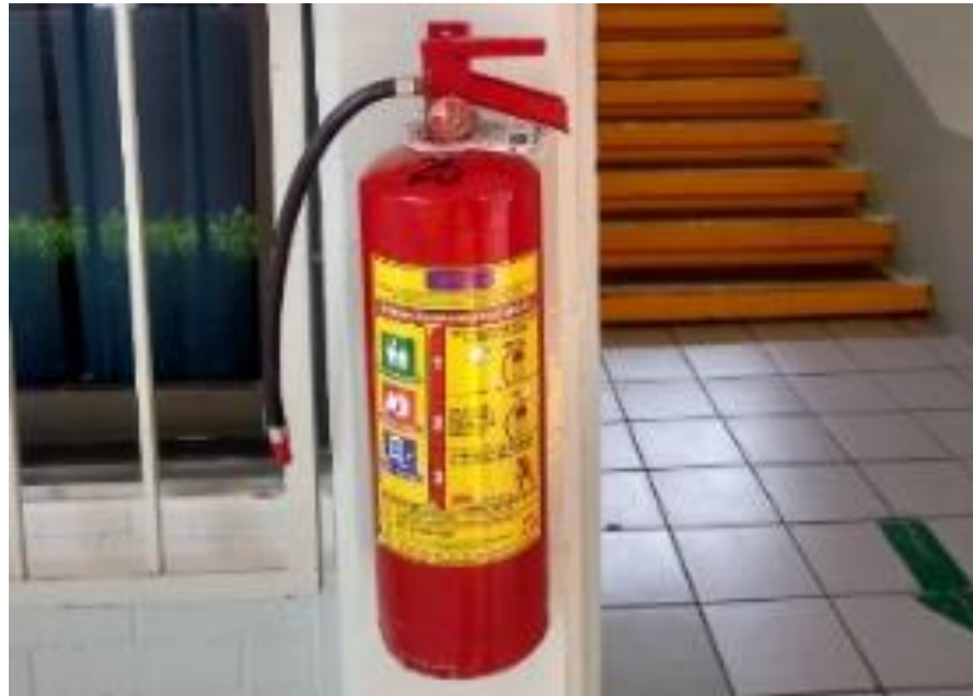
Ilustración 7 Conteo de extintores y supervisión de caducidad adecuada
