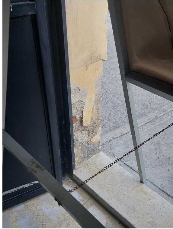
IMAGEN 27. Levantamiento de deterioros en boquillas e interiores del edificio Nezahualcóyotl 29. Fotografía por Jonathan Franco, marzo 2025.
