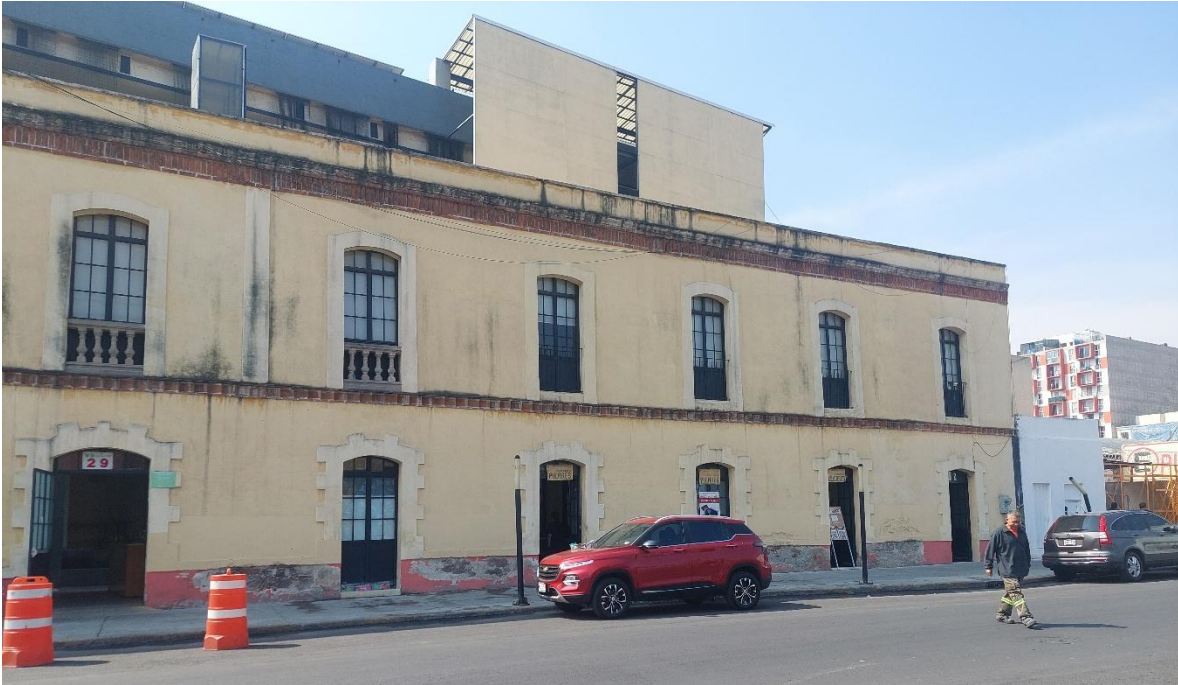
IMAGEN 25. Levantamiento de deterioros en fachada principal del edificio Nezahualcóyotl 29. Fotografía por Jonathan Franco, marzo 2025.
