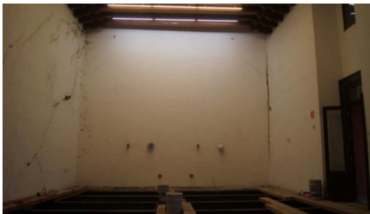
IMAGEN 07. Agrietamientos en muros y acabados en la pinacoteca del Templo de la Rectoría de San Felipe Neri, La Profesa. Fotografía por el equipo del Fideicomiso, agosto 2024.
