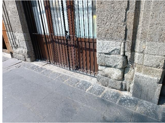
IMAGEN 20. Levantamiento de deterioros en cantera de fachada del edificio del Fideicomiso. Fotografía por Jonathan Franco, marzo 2025.
