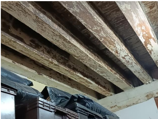
IMAGEN 21. Levantamiento de deterioros en vigería del edificio del Fideicomiso. Fotografía por Jonathan Franco, marzo 2025.
