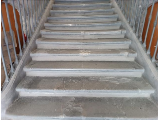
IMAGEN 19. Levantamiento de deterioros en cantera de escaleras del edificio del Fideicomiso. Fotografía por Jonathan Franco, marzo 2025.
