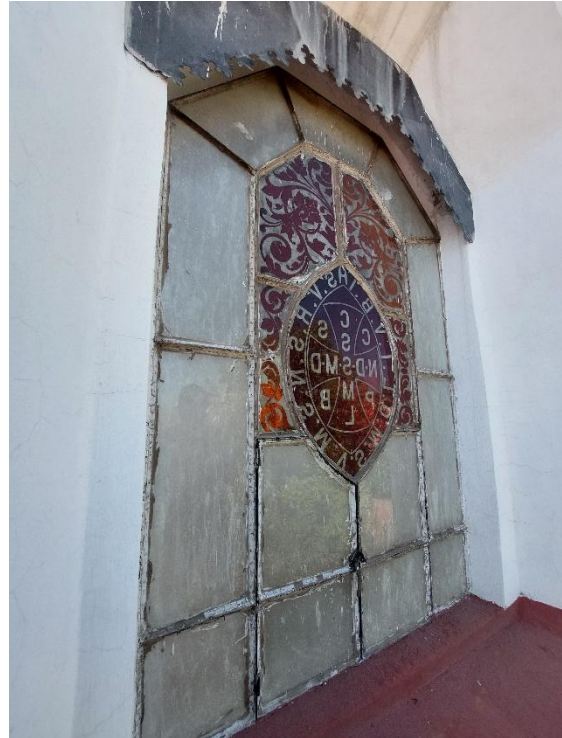
IMAGEN 17. Deterioros en ventanas y vitrales del Templo de San Juan de Dios. Fotografía por Jonathan Franco, enero 2025.
