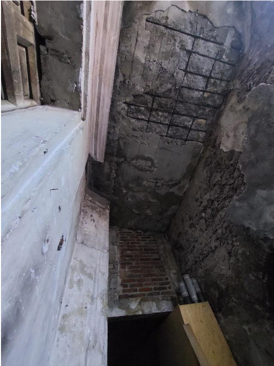
IMAGEN 16. Deterioros en espacio anexo del Templo de San Juan de Dios. Fotografía por Jonathan Franco, enero 2025.
