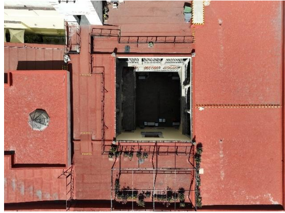
IMAGEN 24. Levantamiento de deterioros en azotea del edificio del Fideicomiso. Fotografía por Jonathan Franco, marzo 2025.
