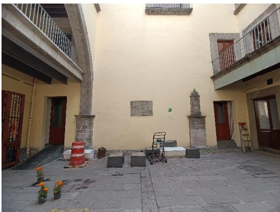
IMAGEN 23. Levantamiento de deterioros en fachada interior del edificio del Fideicomiso. Fotografía por Jonathan Franco, marzo 2025.
