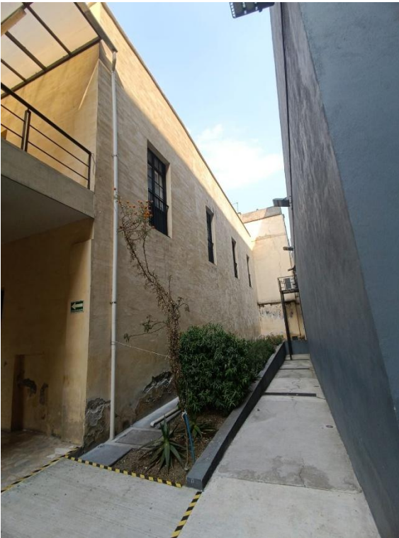
IMAGEN 26. Levantamiento de deterioros en fachada interior del edificio Nezahualcóyotl 29. Fotografía por Jonathan Franco, marzo 2025.
