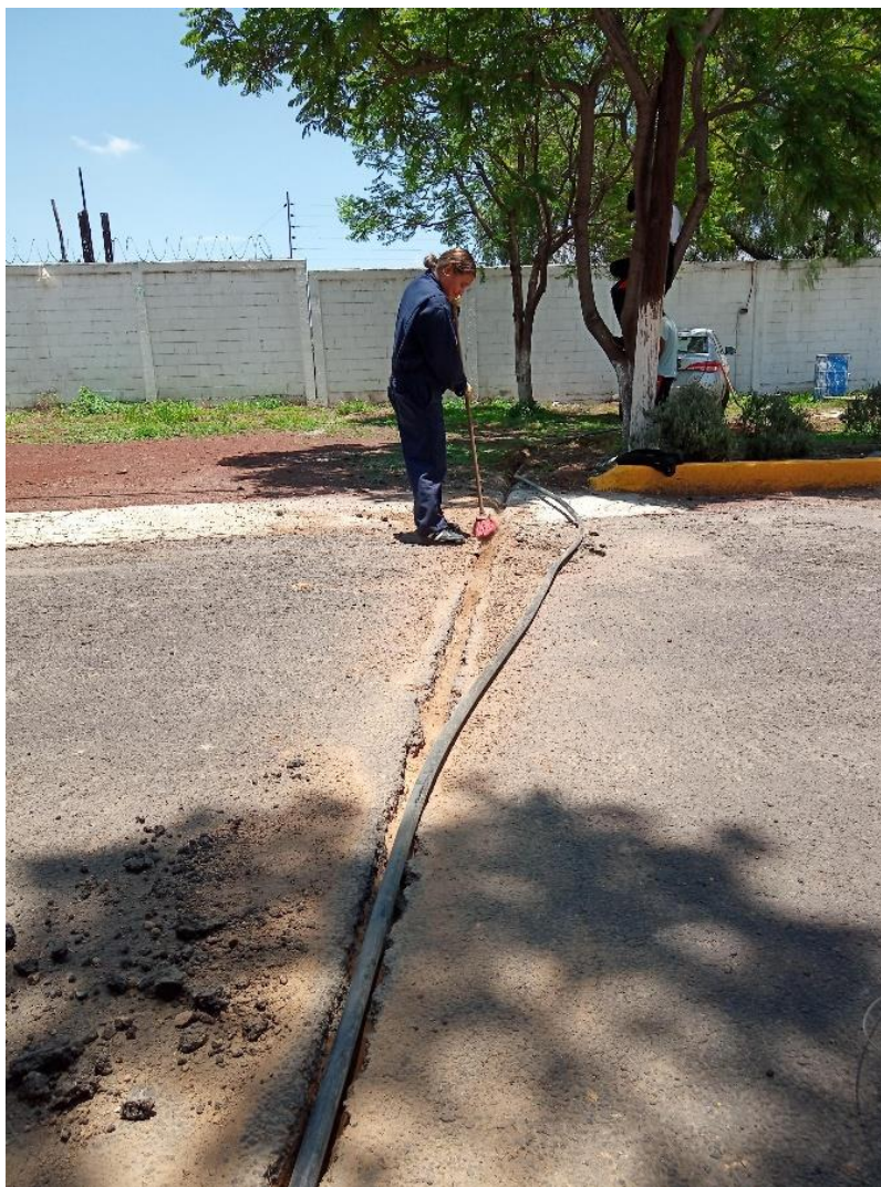
Fotografía 36. Extensión de sistema de riego
