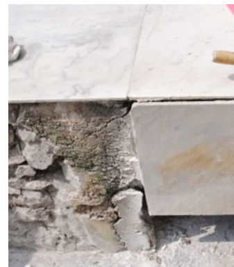
Imagen 7. Desprendimiento del material
