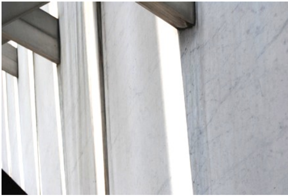
Imagen 4. Esgurrimientos en mármol
