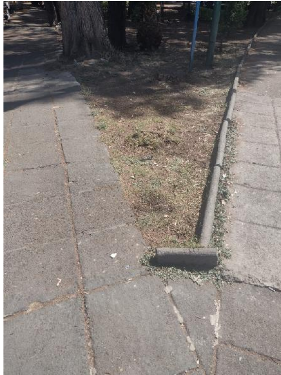
Imagen 18. Falta de cintilla en banqueta en esquina 20 de agosto y Xicoténcatl Fuente: Fotografía propia, febrero 2024.
