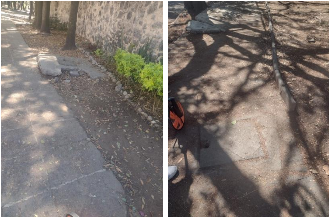
Imagen 27. Tapas de registros en mal estado. Fuente: Fotografía propia, febrero 2024
