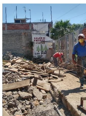
16. Edith Martínez, año 2023, Fotografía de limpieza de terreno en el área de museo, obra Tlaxilacalli
