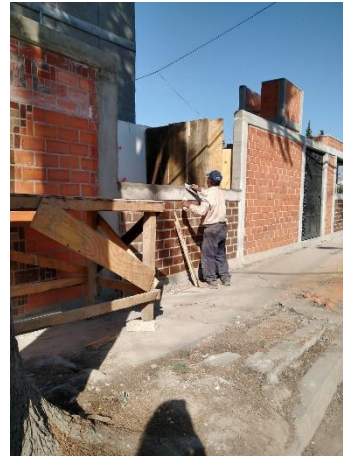
23. Edith Martínez, año 2023, Fotografía acabado de cadenas en barda perimetral, obra Tlaxilacalli
