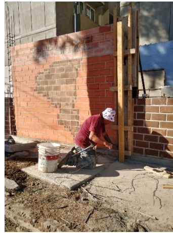
10. Edith Martínez, año 2023, Fotografía de Habilitado de cimbra para castillo de barda perimetral.
