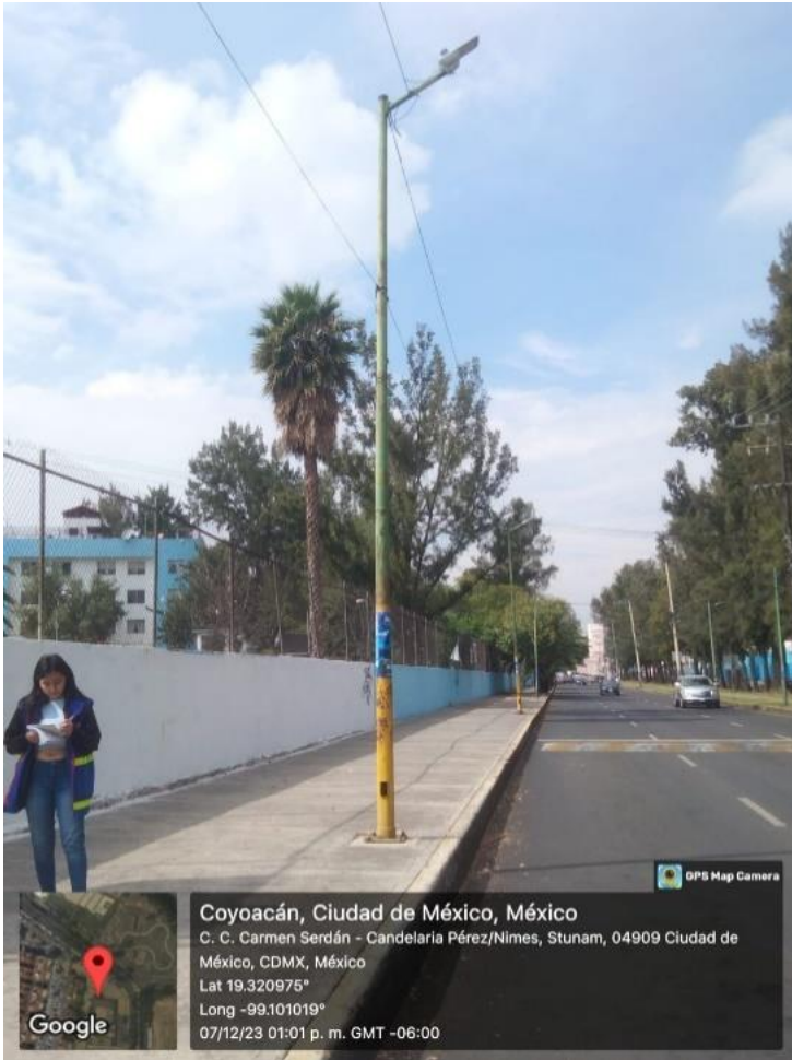
Imagen 8. _ Localización de la luminaria
