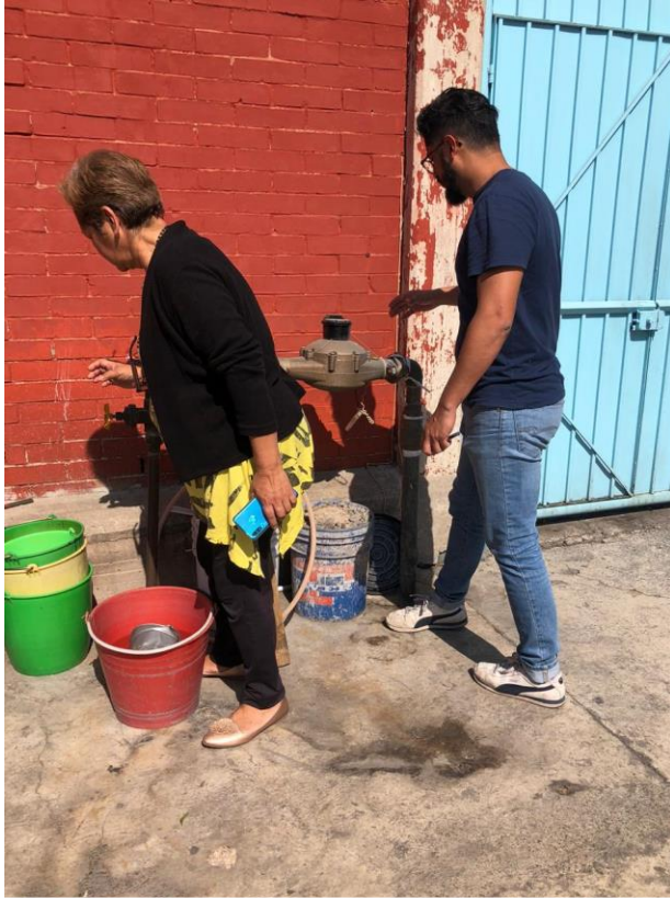
Imagen V: Conexiones de tubería.
