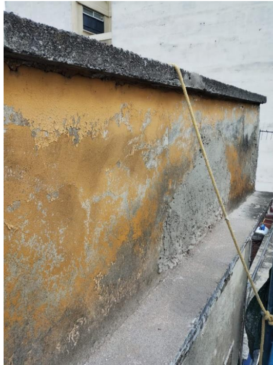
Figura 12. Deterioro por humedad en el pretil de la azotea.
