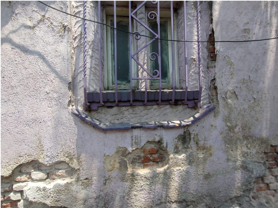
Figura 7. Deterioro por humedad en el contorno del vano.
