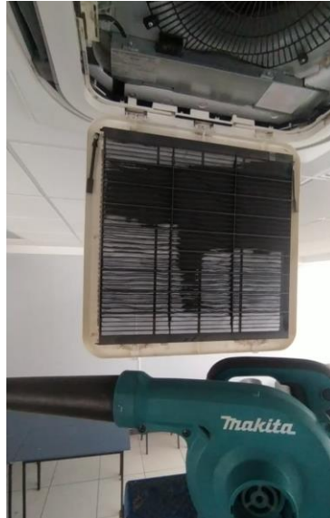
Figura 18 Gestión de Salones para el correcto funcionamiento del aire acondicionado, mejorando la calidad del ambiente.
