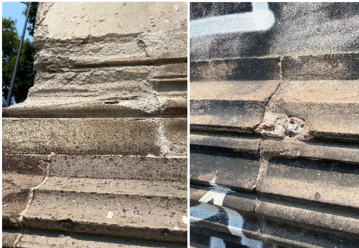
Daños y deterioros en fachada (Fotografías propias, 2022)
