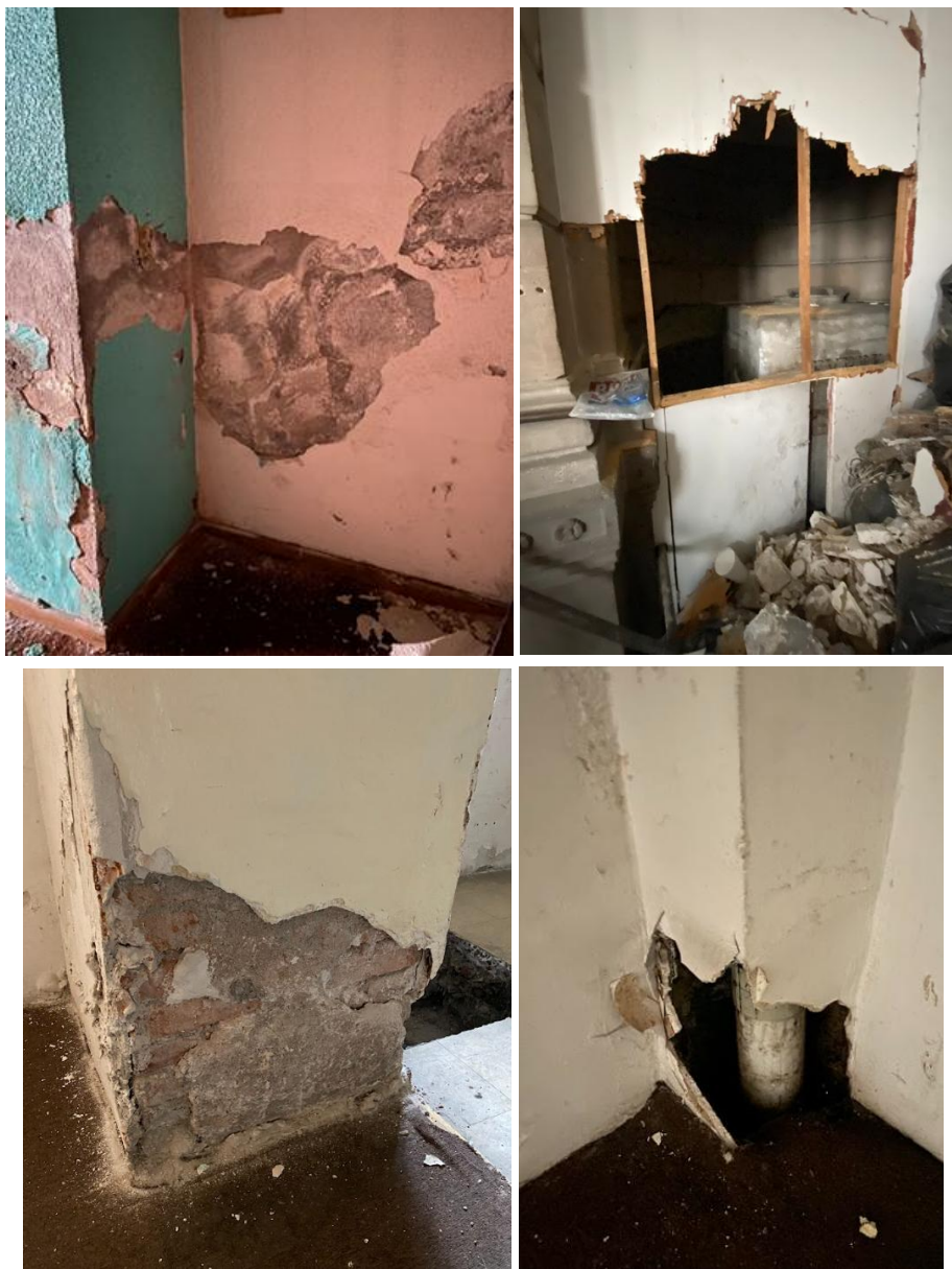
Daños en muros de planta baja. (Fotografías propias, 2022)
