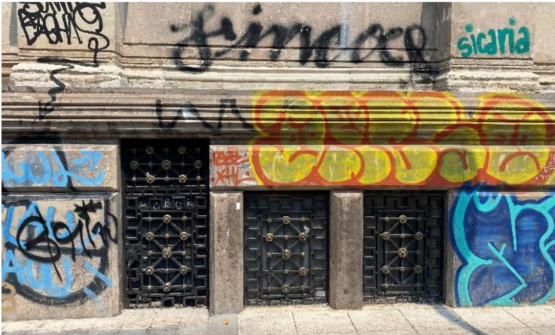
Daños y deterioros en fachada (Fotografía propias, 2022)
