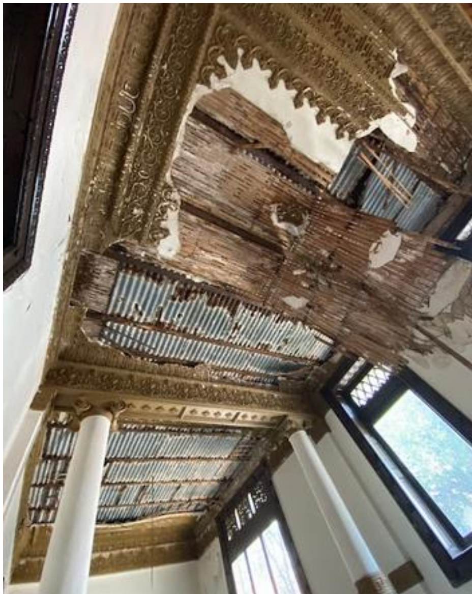
Daños en techumbre de primer nivel. (Fotografías propias, 2022).
