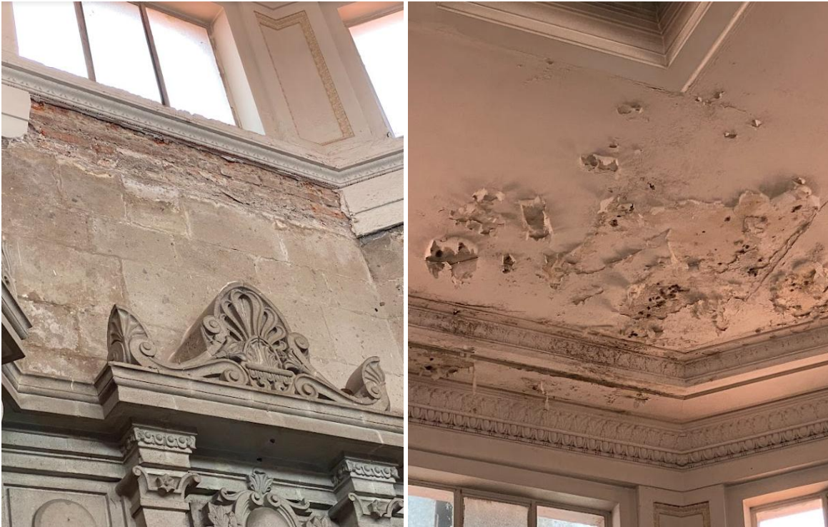
Humedad y filtraciones de agua en plafón de patio central (Fotografías propias, 2022)
