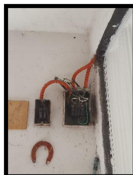
Sistema eléctrico deficiente.
