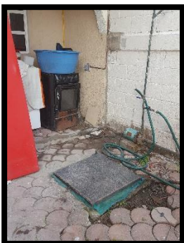
Cisterna con bombeo exterior en funcionamiento.
