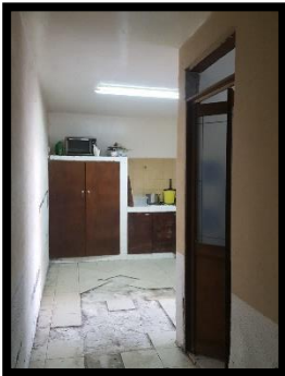
Pisos levantados por humedad.
