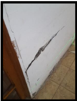
Rastro salitroso y desmoronamiento de aplanado.
