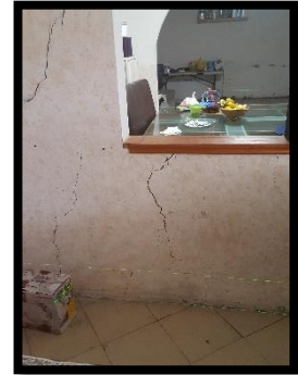
Agrietamiento en aplanado de muro.
