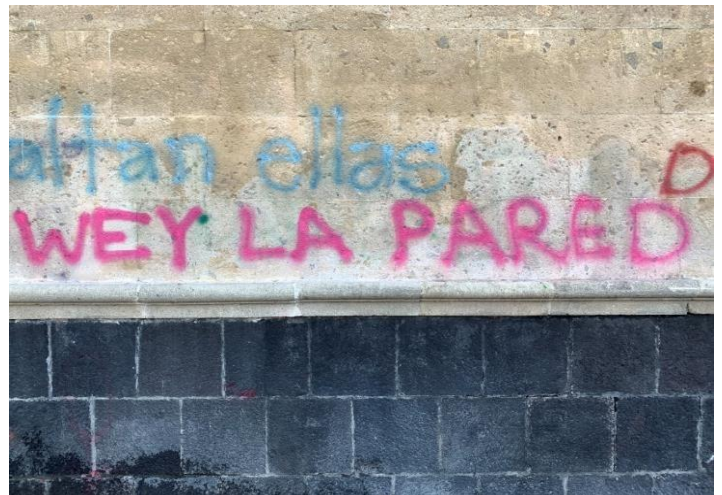
Imagen 17. Registro fotográfico de las pintas en la fachada Poniente de Palacio Nacional.
