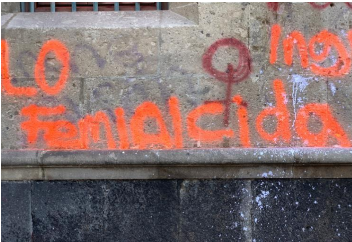
Imagen 16. Registro fotográfico de las pintas en la fachada Poniente de Palacio Nacional.
