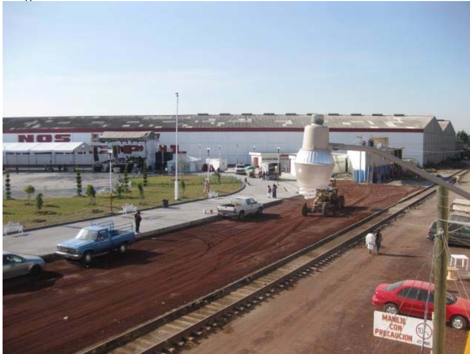
Anexo 7. Mejoramiento provisional de calle perimetral. Foto tomada en marzo 1 de 2015. Día de la inauguración
