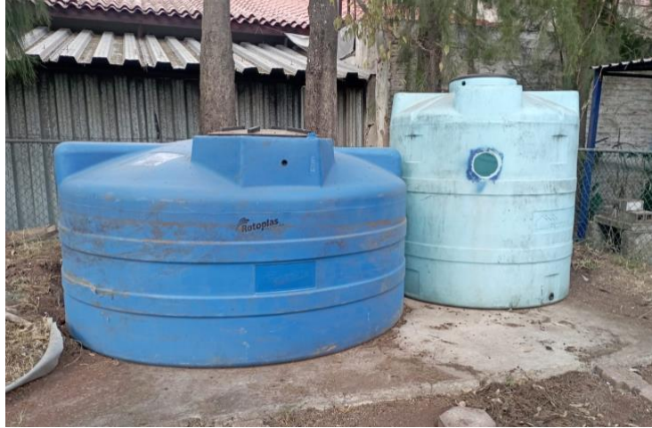
Figura 3. Los dos tambos de agua colocados a un lado de cárcamo.
