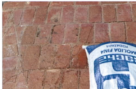
Grietas en cubierta.
