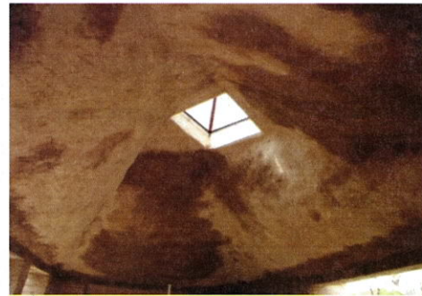
Exceso de humedad en cubierta.
