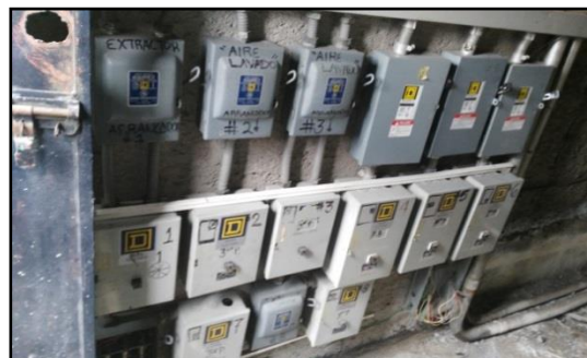
IMAGEN 10. Para posteriores modificaciones en el nivel de azotea, es necesario contar con el registro y la ubicación de la instalación eléctrica existente.
