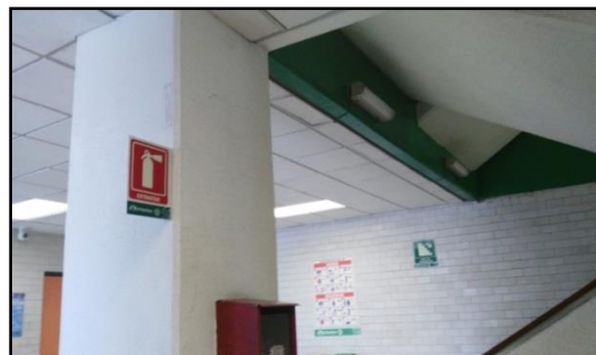
IMAGEN 6. Para las obras inducidas era necesario un registro de todos los equipos contra incendios y su localización exacta.
