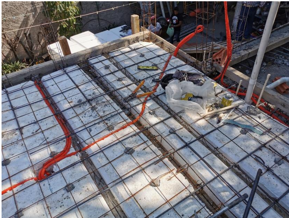
Imagen 39. Losa tapa de vigueta y bovedilla con instalaciones ahogadas
