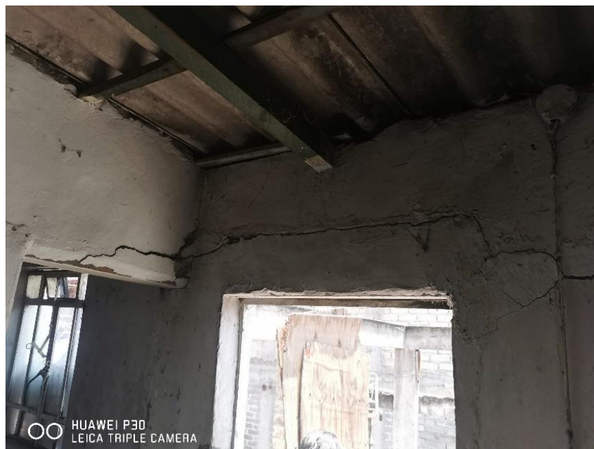
Imagen 22. Fisuras por golpeteo de vivienda debido a falta de separación de colindancias.
