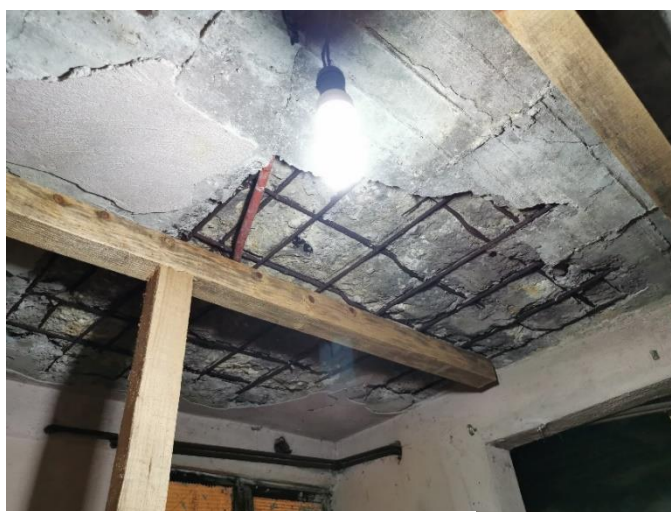
Imagen 25. Desprendimiento de recubrimiento del lecho inferior.
