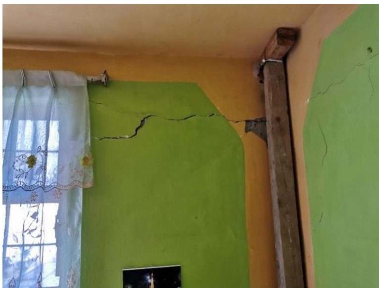
Imagen 23. Fisuras por cortante.
