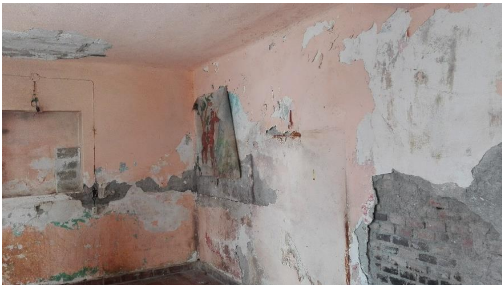
Imagen 48. Interior de la vivienda con severos problemas de humedad.
