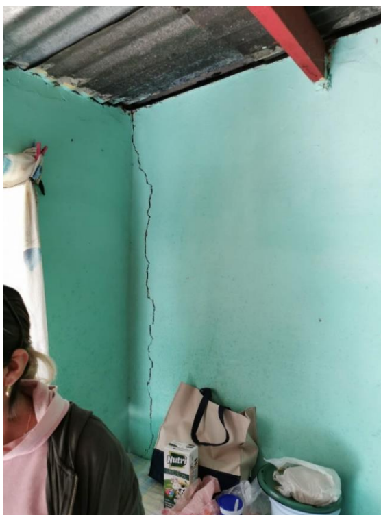
Imagen 18. Vista interior del muro de la vivienda ubicada en Calle Carreta #19 San Gregorio Atlapulco
