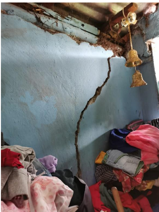
Imagen 24. Fractura de muro por falta de confinamiento.
