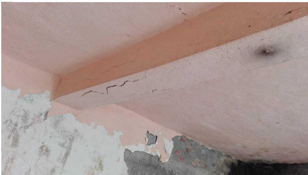
Imagen 50. Interior de la vivienda con fractura de trabe y falla por deflexión
