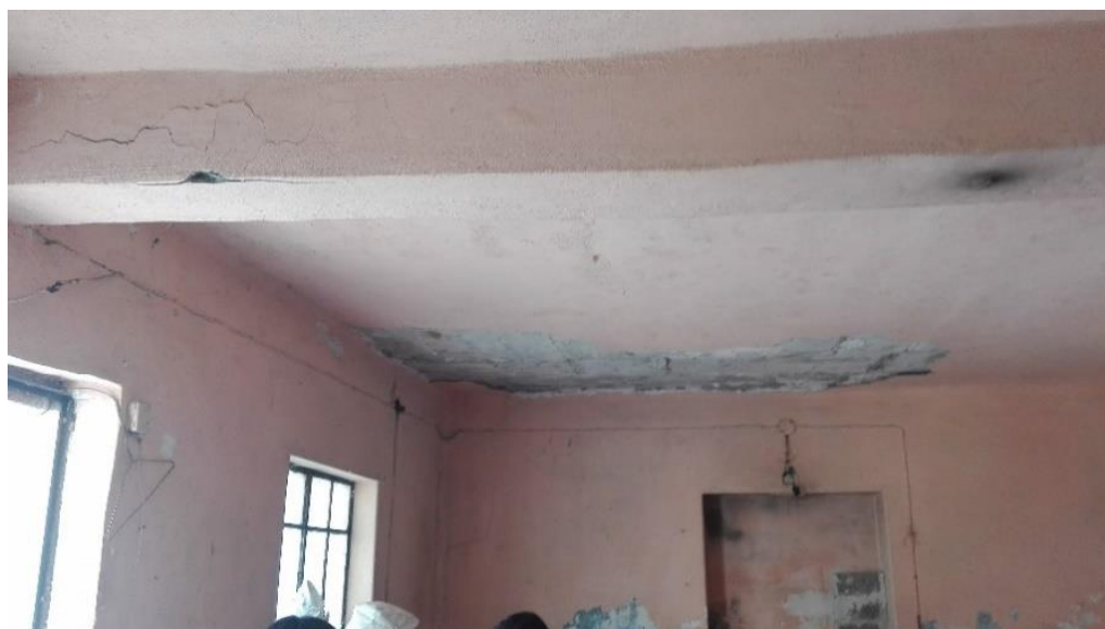
Imagen 51. Interior de la vivienda, fractura de trabe, desprendimiento de aplanado y falla por deflexión.
