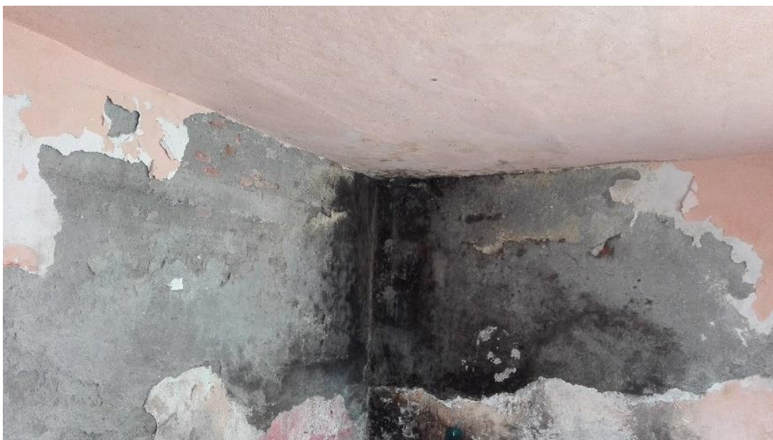
Imagen 49. Interior de la vivienda con severos problemas de humedad.
