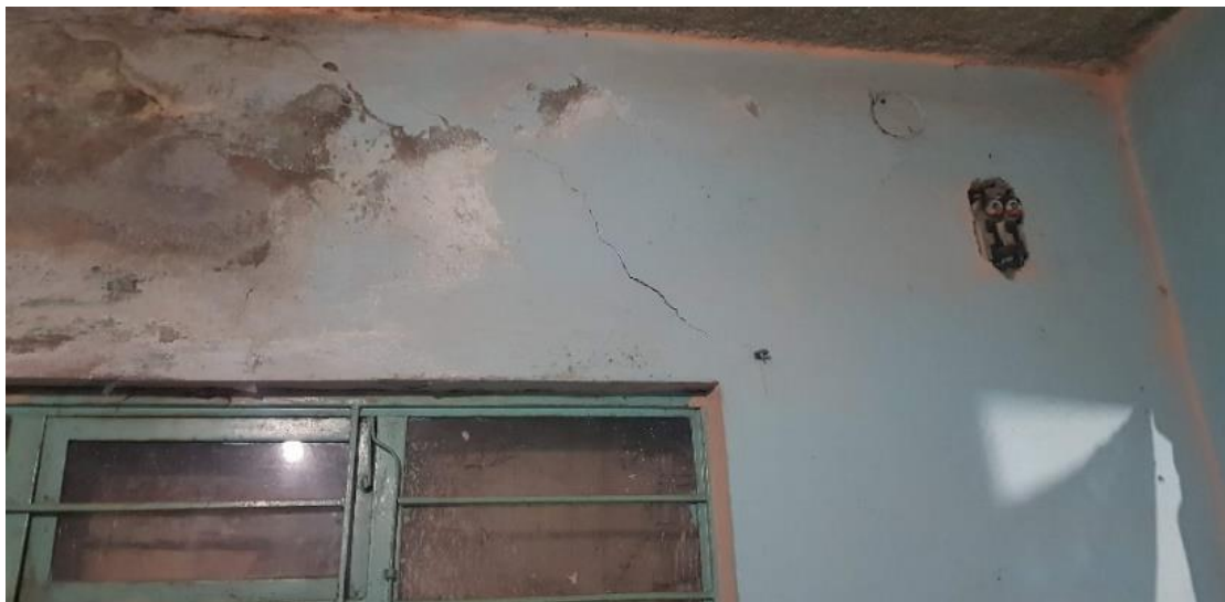
Imagen 60. Fisuras en muro y elementos estructurales.
