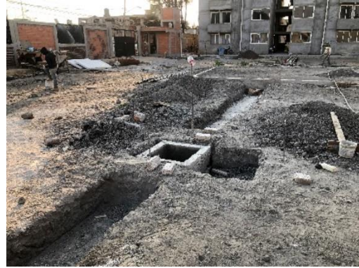
Imagen 16: Excavación de cepas para colocación de tubo corrugado de instalaciones sanitarias. Proyecto Tlaxilacalli (2023).
