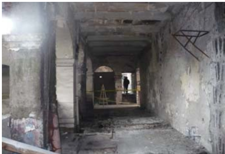
En el primer piso muestra severas grietas en la techumbre así como tensores que apoyan la estabilidad del edificio
