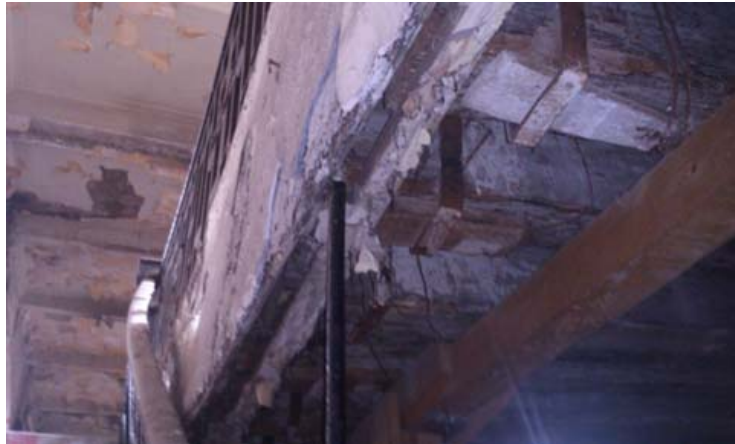
Una de las escaleras está en mal estado se está desprendiendo y tiene escombros del techo
