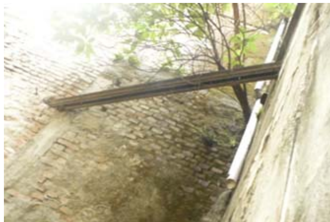
Presencia de vegetación nociva en las estructuras superiores del ex convento
