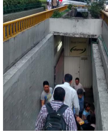
Puente Anillo Periférico (Adolfo López Mateos) y Calle Monte Elbruz (deprimido): aplicación de pintura en muros zona escalera.
