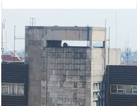
Imagen 36. Depósito Tanque Elevado
