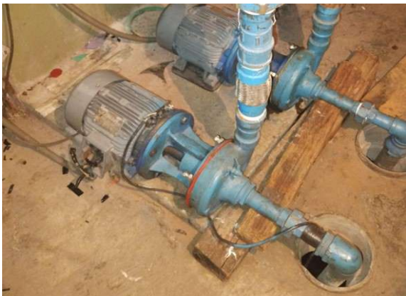
Imagen 35. Bombas de 5.0 HP
