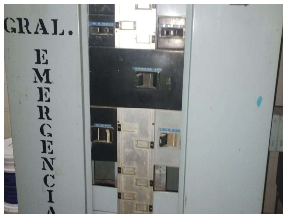
Imagen22. Tablero de control
