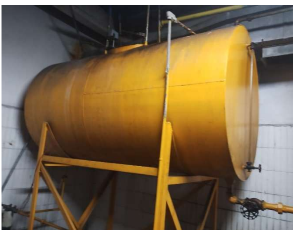
Imagen 25. Tanque de diésel
