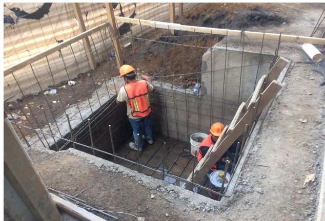
Fotografía No 1. Visita de obra en la Territorial Tasqueña, supervisión en el armado de acero para la cisterna.
