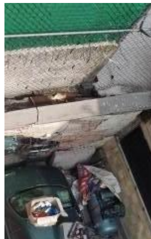
Falta de tapajuntas y material expuesto de muro.
