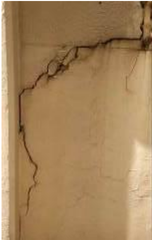
Grieta en muro de colindancia sur.
