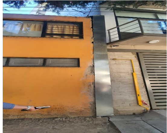
Foto 2 tomada protección civil 03 de febrero 2022
