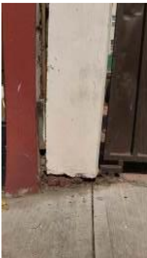
Castillo sur con inclinación en la base de muro de lindero sur
