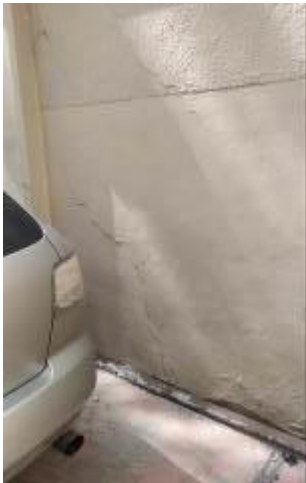
Grieta en muro sur de colindancia.
