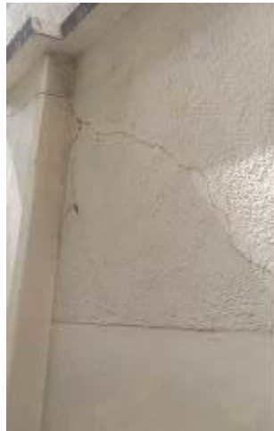
Grieta en material de acabados.
