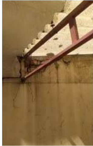
Anclaje de techumbre a muro dañado.
