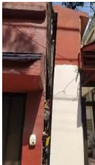
Junta constructiva sur, con escombros y basura.
