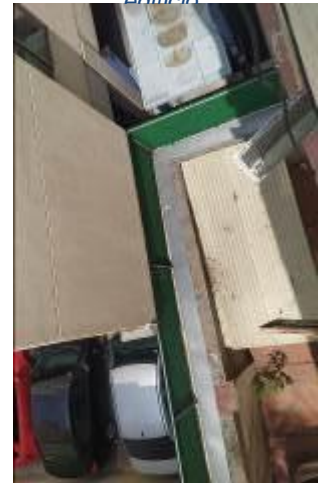
Tapajuntas metálico en zona afectada.
