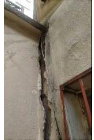
Separación de elementos de muro de lindero y edificio.
