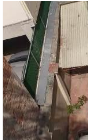
Vista de azotea, de la zona dañada en muro sur.
