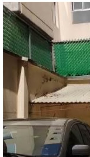
Muro sur-poniente con grietas y desprendimiento de material
