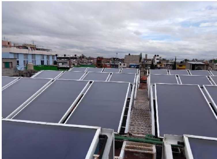
Ilustración 5.1. Captadores solares instalados en azotea del molino Cricotl
