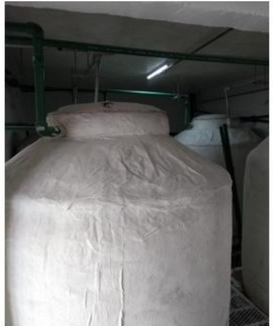
Ilustración 5.2. Tanques con aislamiento térmico en molino Cricotl
