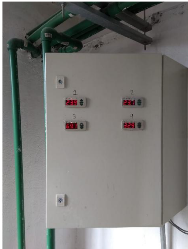
Ilustración 5.3. Monitor de temperatura de termo tanques en molino Cricotl
