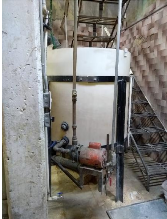
Ilustración 5.5. Tanque de sedimentación instalado en molino Cricotl
