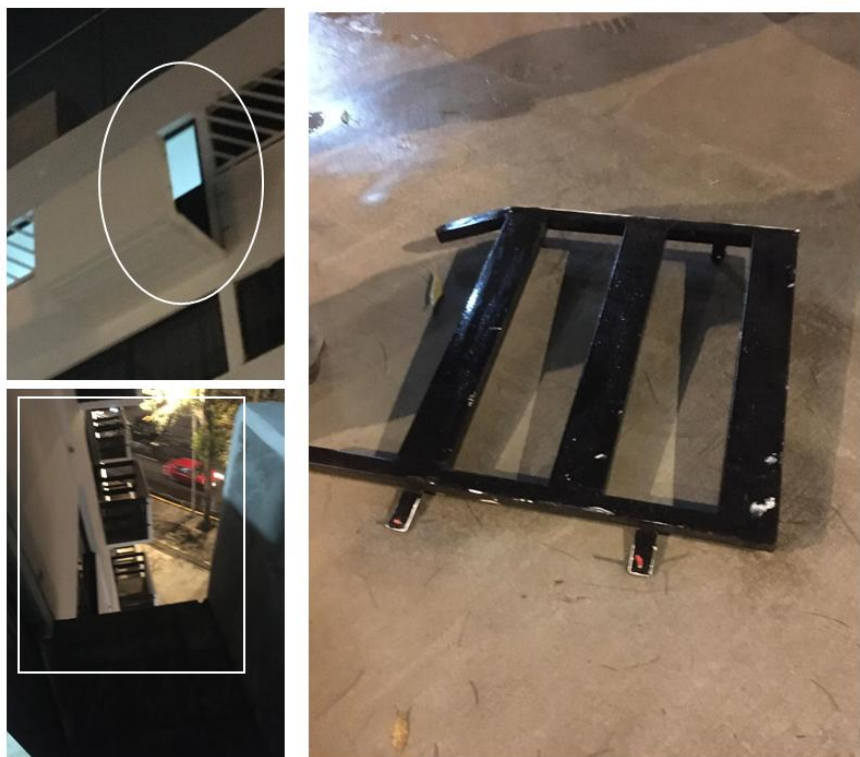
Figura 4.13. Caída de barandal de herrería de un balcón edificio 2B
