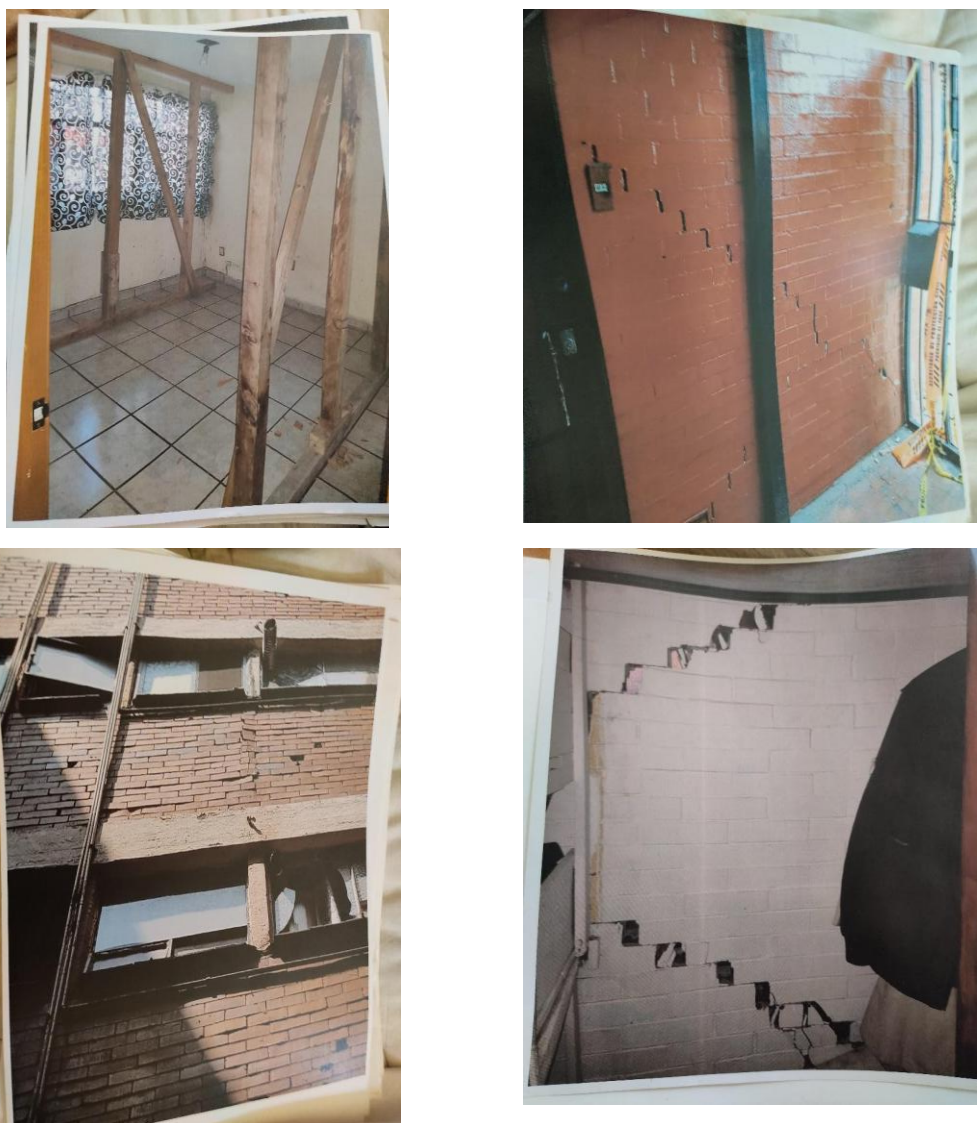
Figura 4.3. Daños postsísmicos en departamentos del Multifamiliar Tlalpan
