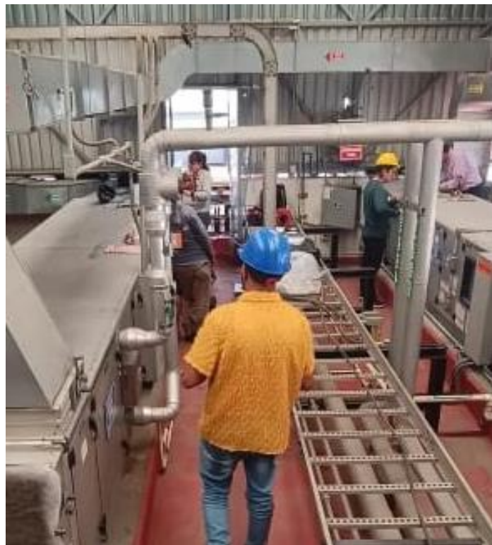
Figura anexa 20: Área de mantenimiento; Ductos de Sistema de Aire acondicionado HVAC. Parte interna.
