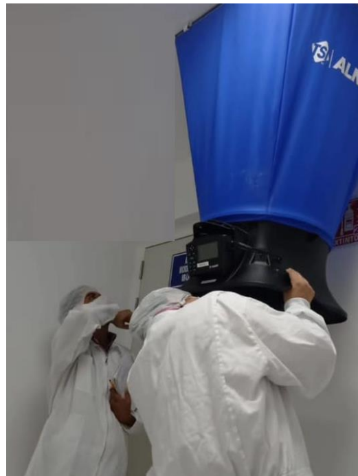
Figura anexa 6: Uso de Balometro en pruebas de flujo de aire para sistema HVAC
