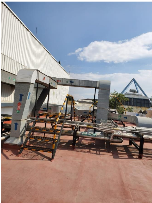
Figura anexa 19: Área de mantenimiento; Ductos de Sistema de Aire acondicionado HVAC. Parte externa
