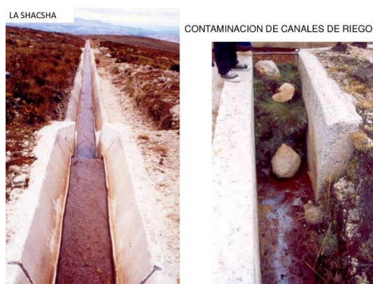
Figura 40. Canales de riego contaminados en Cajamarca Perú
