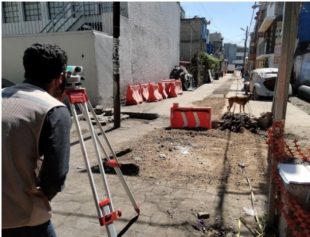
Trazo y nivelación para desplante de estructura para obra hidráulica, con equipo de topografía.
