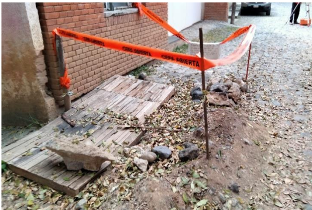
Ubicación de socavón y problemática principal
