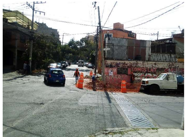
Foto 2.- Frente: Pueblo de "Los Reyes" Demolición de las banquetas en calle cantera esquina Prolongación Santa Tecla en el pueblo de "Los Reyes" Fuente: Elaboración Propia
