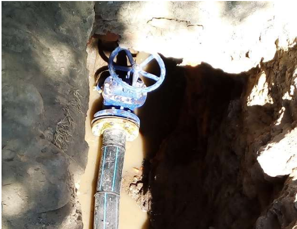
Foto 7.- Frente: “Tlapancalco” Tubería nueva conectada a la nueva válvula, ubicada en Av. Progreso. Fuente: Elaboración Propia
