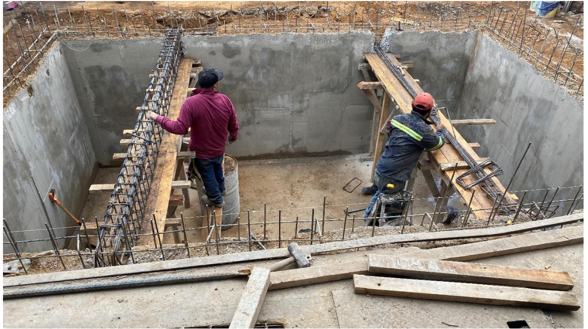
Imagen 3: construcción de armado de cisterna para agua potable del Mercado San Cosme
