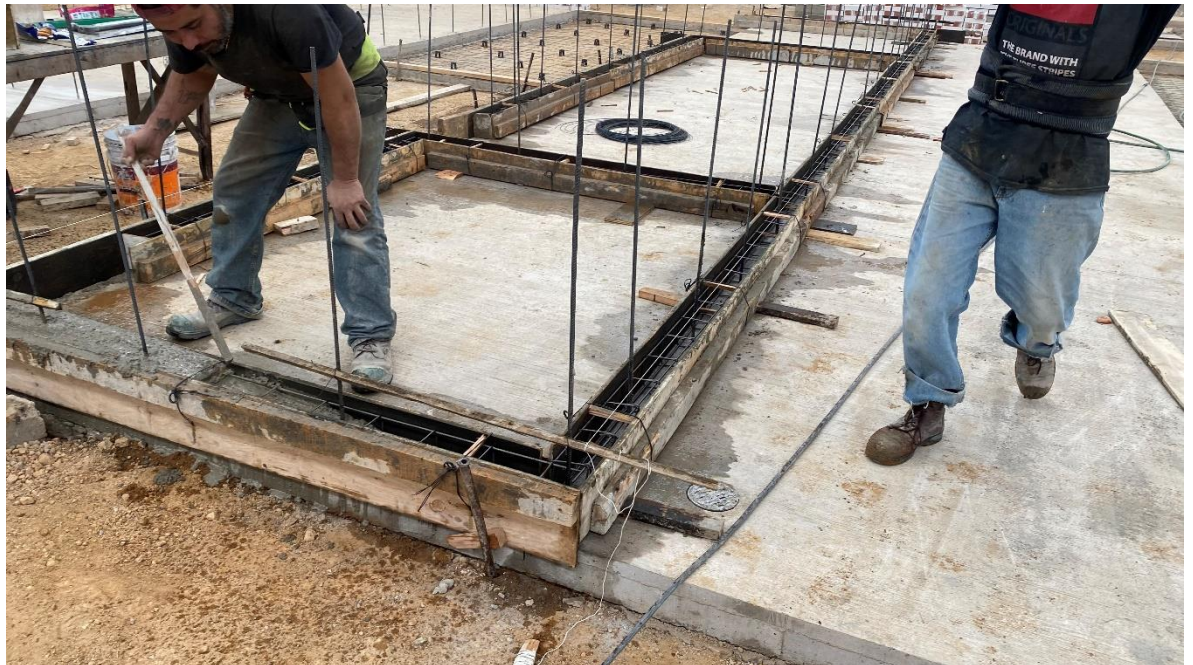
Imagen 4: construcción de pisos y traveses a base de concreto armado para los locales del Mercado San Cosme
