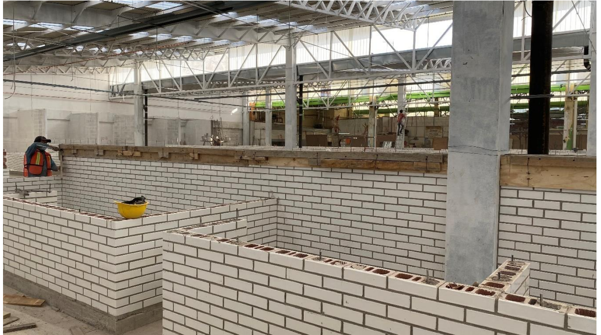
Imagen 1: construcción de muros divisorios a base de block vidriado para locales del Mercado San Cosme
