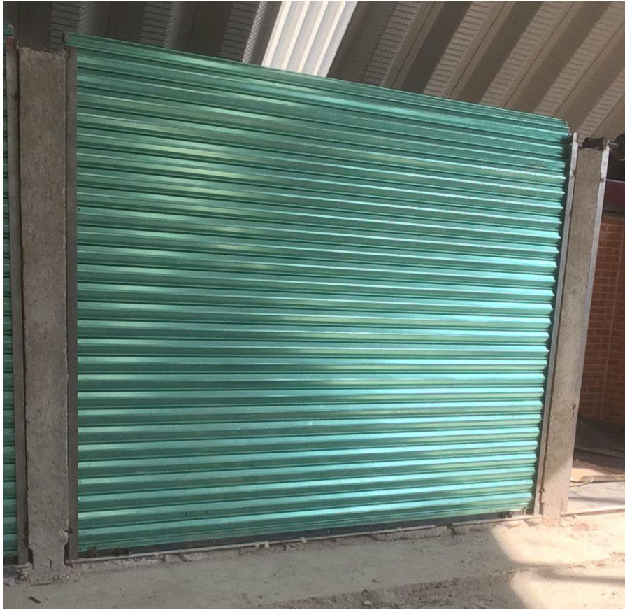
Cortina de acero para locales perimetrales. Mercado la moderna.
