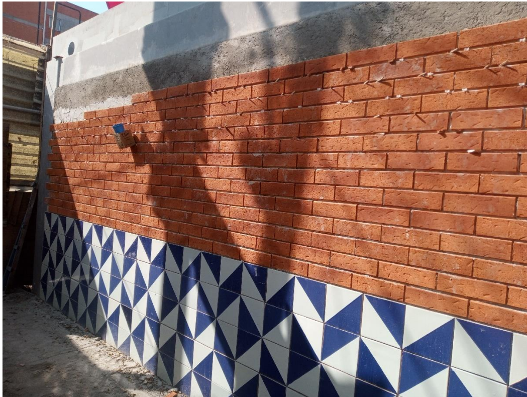
Aplicación de acabado de ladrillo aparente en muros de fachada. Mercado la moderna.
