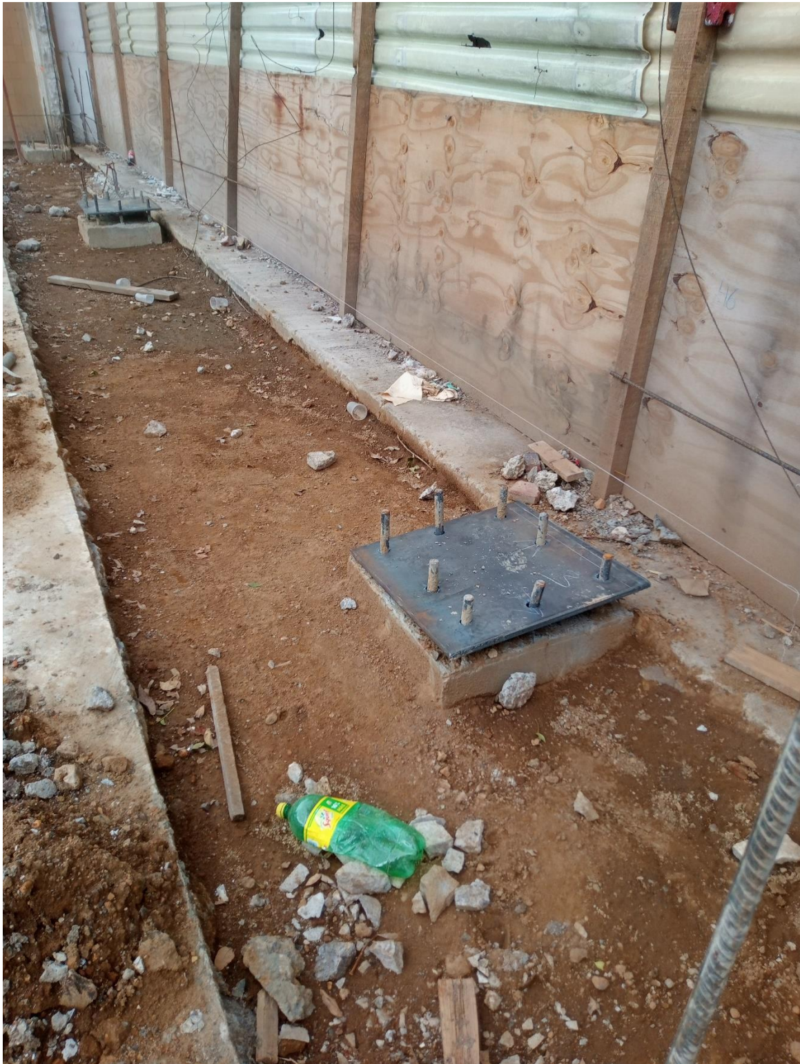
Placa de acero donde se soldarán las columnas de acero. Mercado la moderna.
