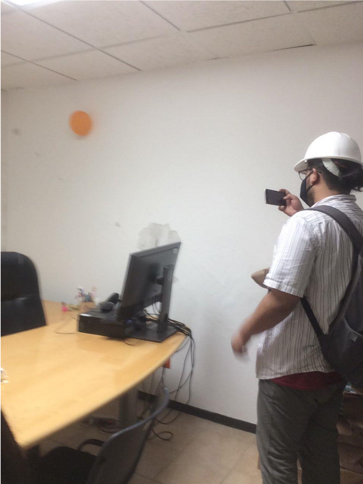
Desprendimiento de acabados debido al sismo. Brigada post sismo.
