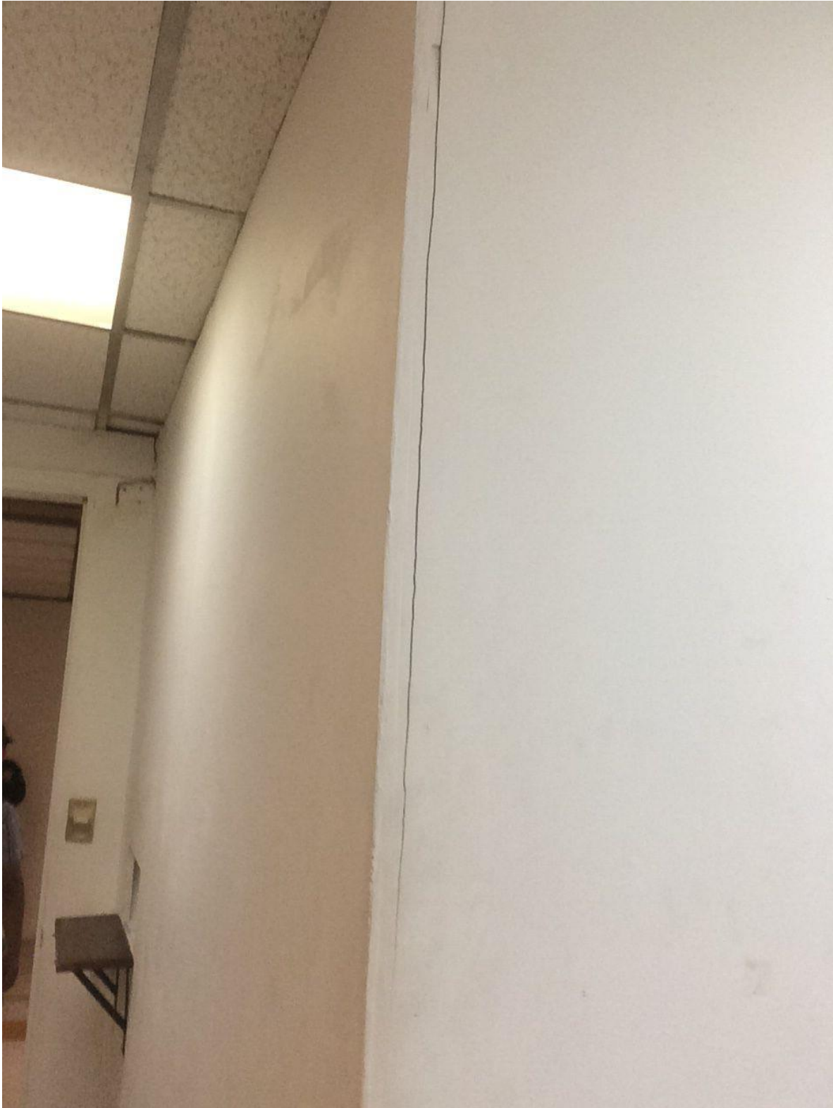
Grietas en muros. Brigada post sismo.
