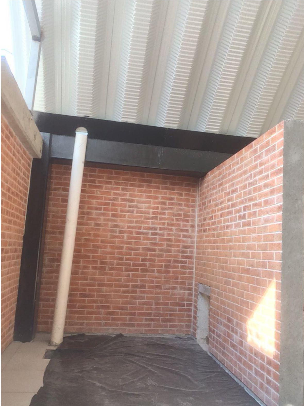
Local perimetral esquinado con tubo de BAP. Mercado la moderna.
