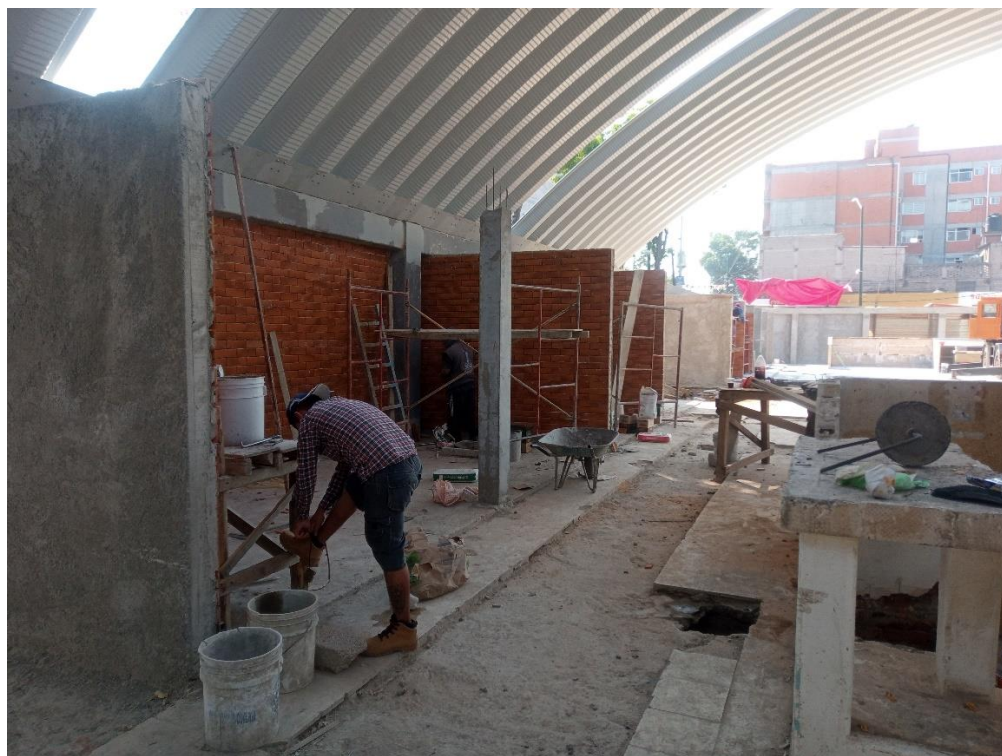
Aplicación de acabado de ladrillo aparente en muros interiores. Mercado la moderna.
