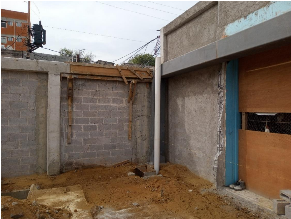
BAP por tubo de PVC de 5" conectado a registro sanitario. Mercado la moderna.
