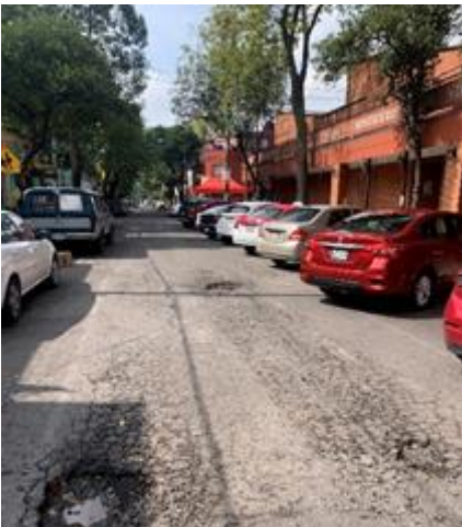
Daños en calle de colonia Narvarte. Fotografía propia.
