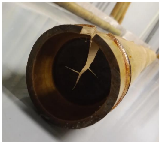
Foto 1. Gritas en el nudo el bambú. Fuente: propia
