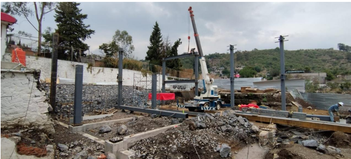
Anexo 2: Armado de cimentación, columnas y traveses para el “Heroico Cuerpo de Bomberos” en la delegación Milpa Alta.
