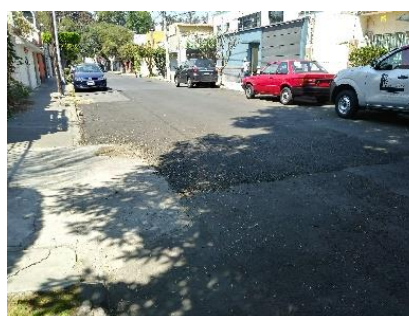
Imagen 17.- Bacheo en calle.
