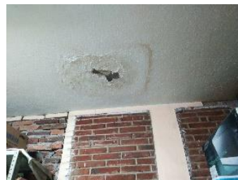
Imagen 29.- Filtración por impermeabilizante.
