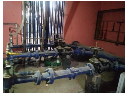
Imagen 15.- Sistema de bombeo
